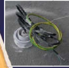
Pool tune installé en dessous du projecteur Piscina tune instalado debajo del proyector
